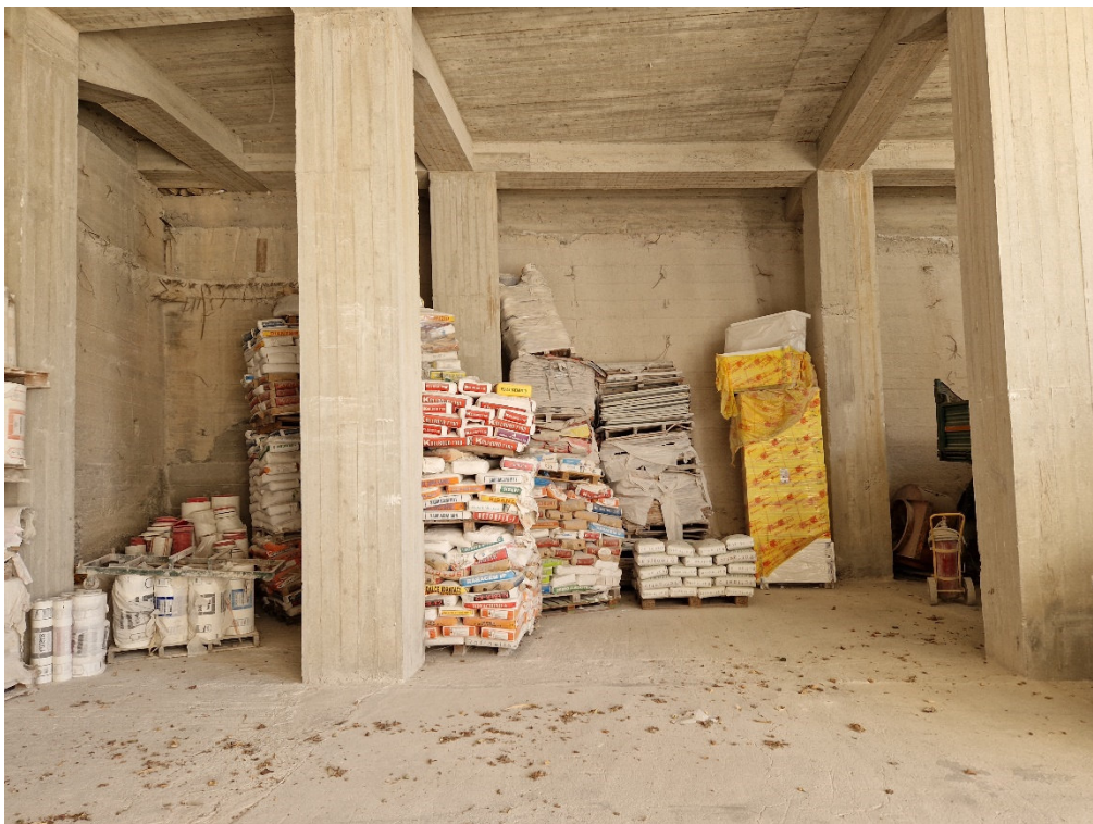
Foto 3 – Materiale accatastato nell'area sottostante il capannone
